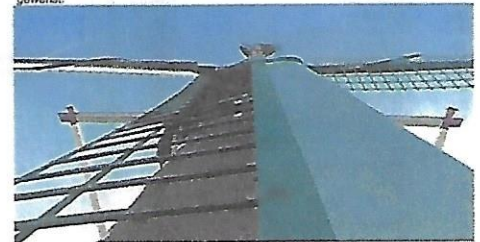
28 De slotbouten in het achterhek roesten sterk op. De profilering van de stroomlijnen zijn niet overeenkomstig met de principes van Van Bussel.
