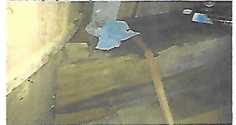
13 Merk de lekkagesporen op de windpeluw.
