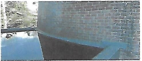
3 Aan de westzijde is een deur dichtgemetseld. Via de oude neggekanten is enige doorslag. Voor het dak van het tussenlid zie het onderhoudsplan van de bijgebouwen.
