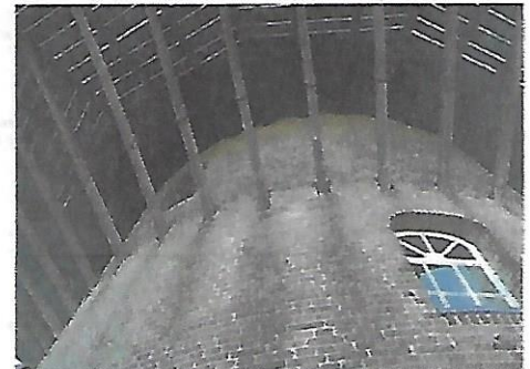
4 De stellingechoren zijn in kassen in de ramp opgelegd. De verankering van de schoren is niet zichtbaar.
