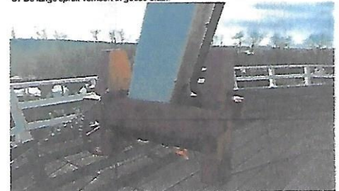
32 De kruisbak is ernstig ingerot en vervanging toe.
