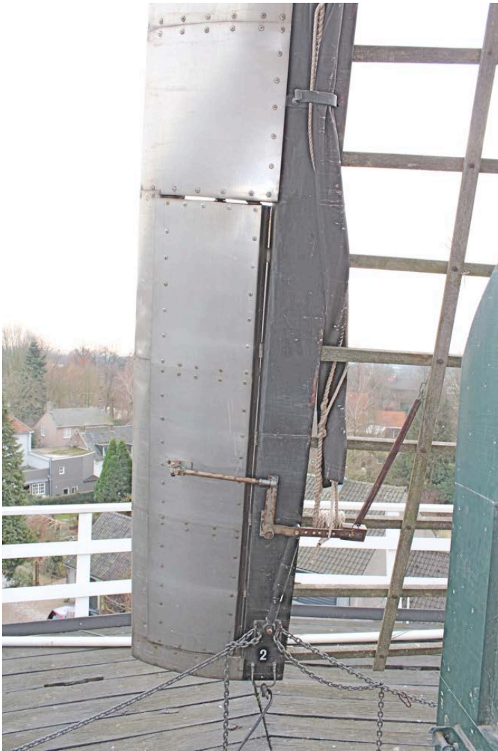
Ijzerwerk van de remkleppen en de Van Busselneuzen vertoont roestvorming.
