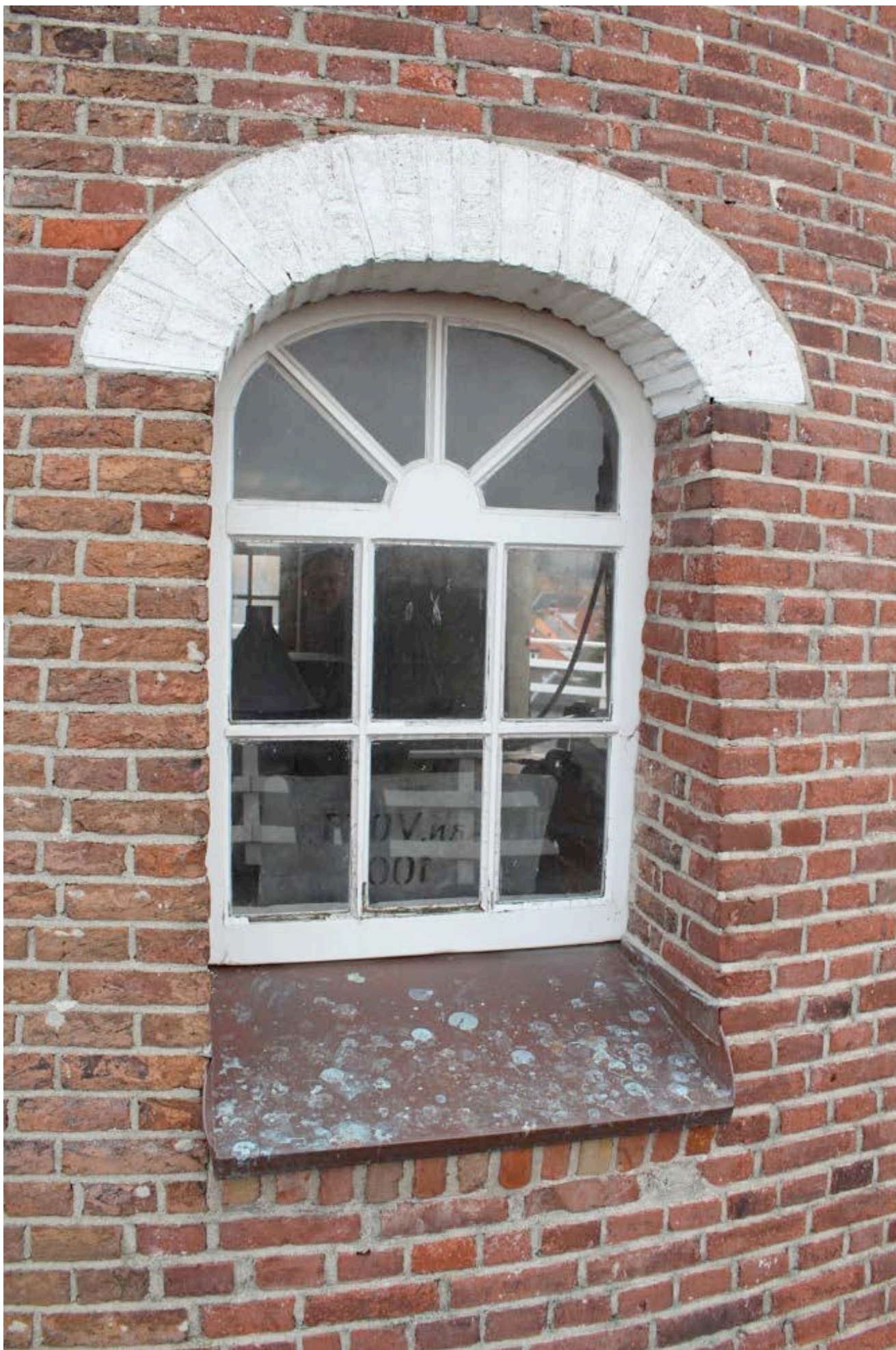
De afzaten zijn voorzien van koper. De hoeken links en rechts onder de ramen zijn echter niet helemaal waterdicht. Van enkele ramen heeft de liggende stopverf losgelaten.
