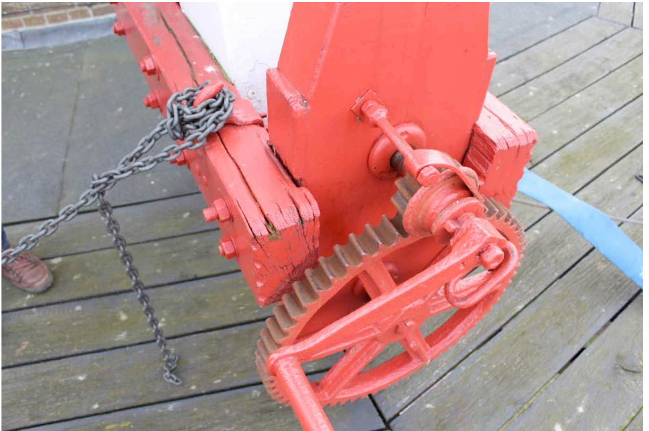
Het hout van de kruibok vertoont droogtescheuren. De kruibok is in goede staat.
