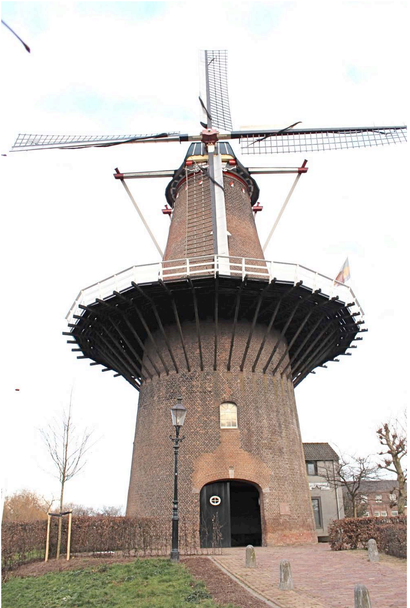
De molen verkeert in een goede staat. Er zijn kleine problemen met uitgevallen cementvoegen, vorstschade en mos en algen.
