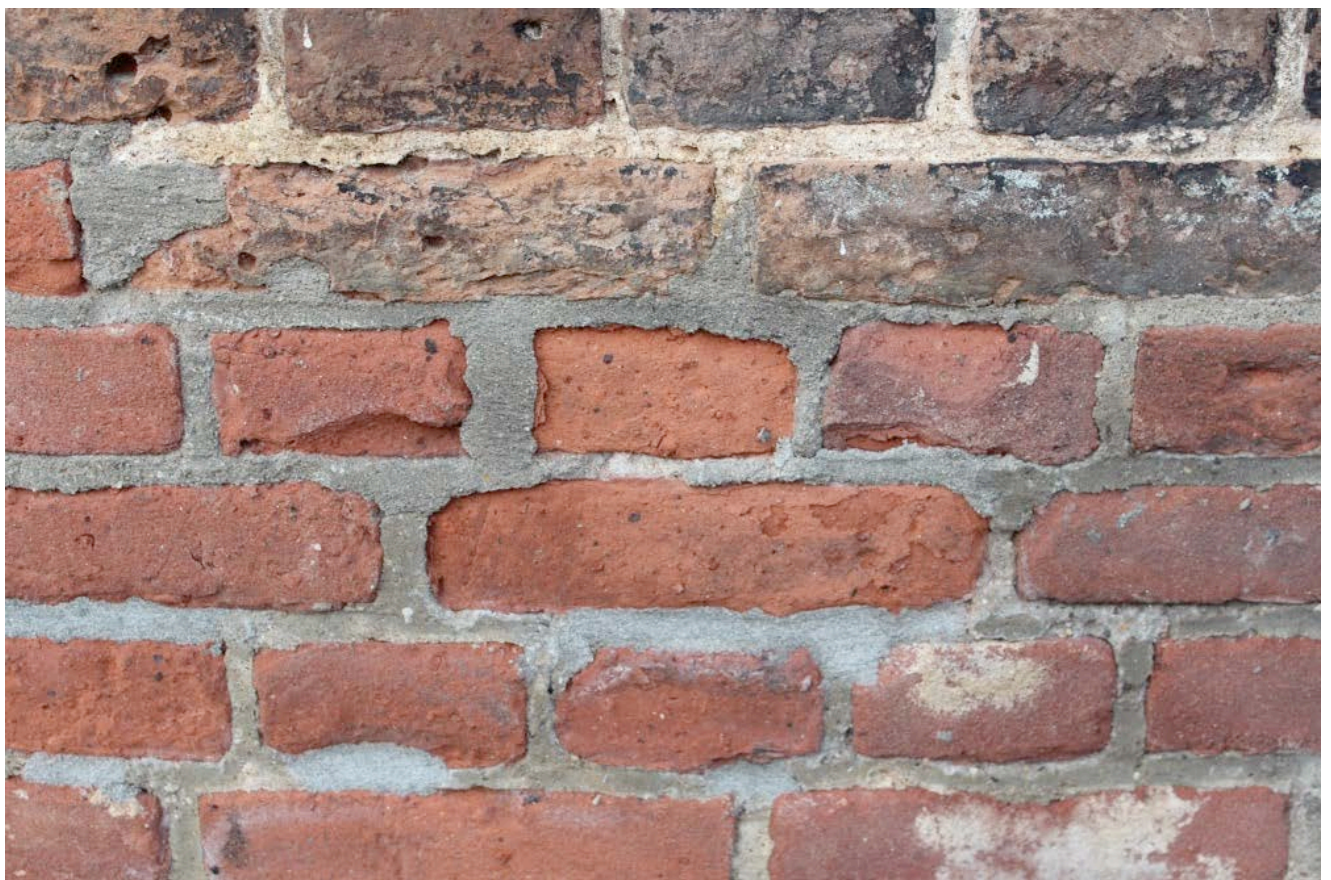
Op enkele plaatsen zijn stuk gevoren stenen, uitgevallen cementvoegen en reparaties met cementmortel. Deze laat hier en daar los.
