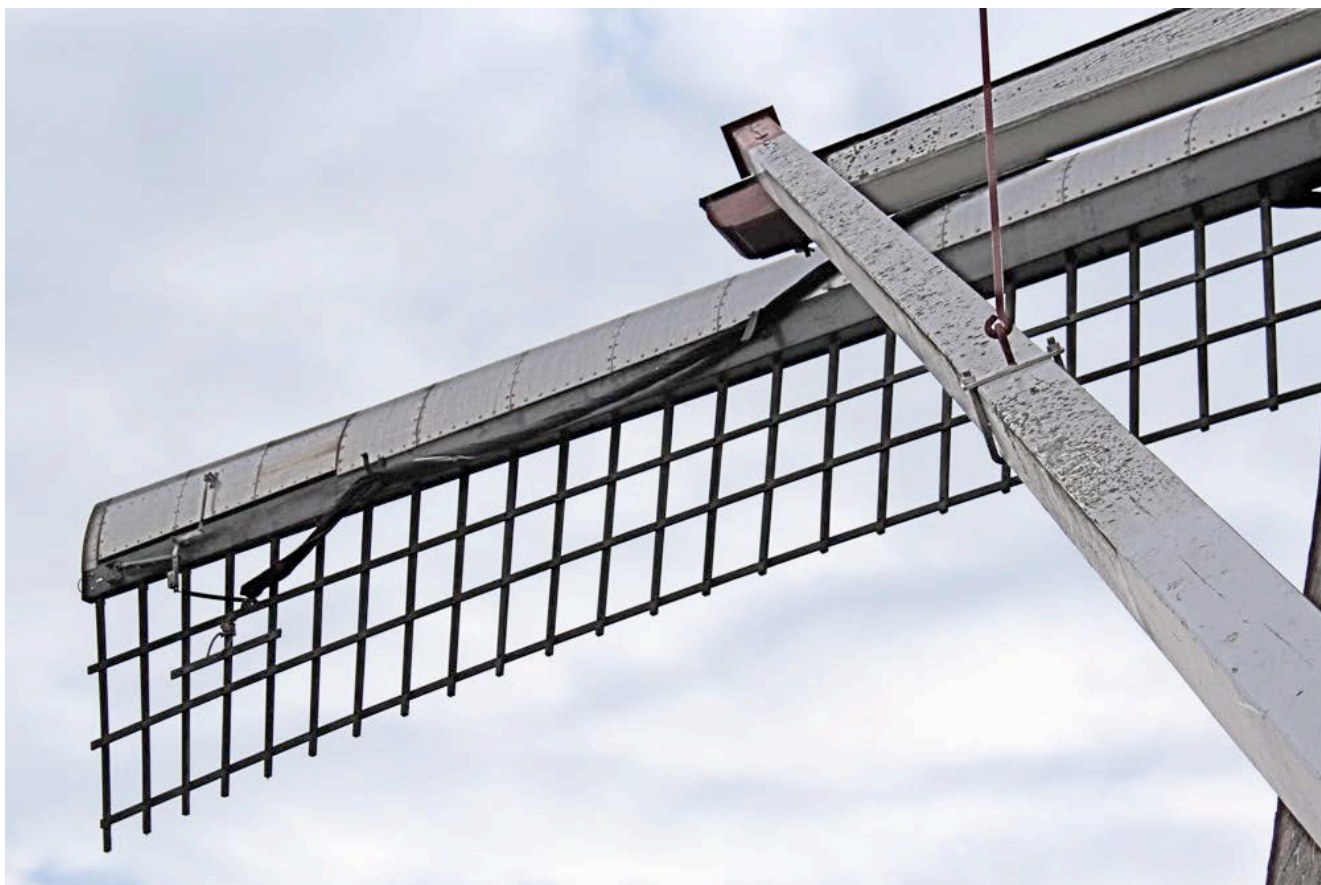
Het schilderwerk van de staart, schoren en spruiten is schraal en vertoont mosgroei.
